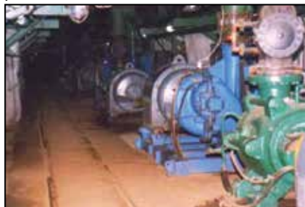
Banco de bombas de deshidratación.
