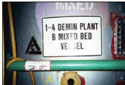
Vista externa del tanque.
