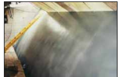
La parte superior de la compuerta fue recubierta con 2 manos de ARC S2.
