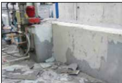
Recubrimiento averiado después de derrames.
