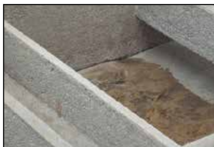
Recipiente del filtro de arena drenado.
