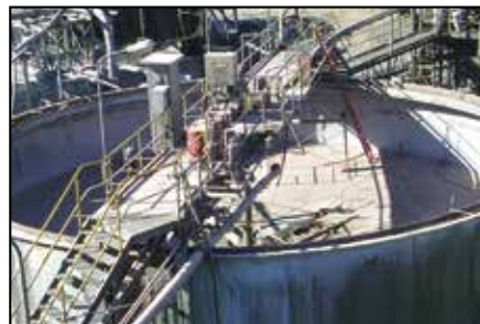
Espesador de lodos en una importante mina sudamericana.
