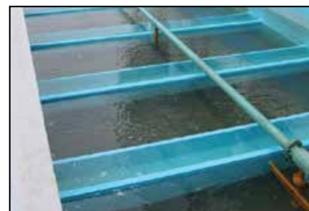
Filtro de arena en servicio.
