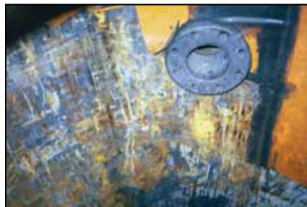
Remoción del revestimiento de caucho en progreso. El ampollado del revestimiento es visible.
