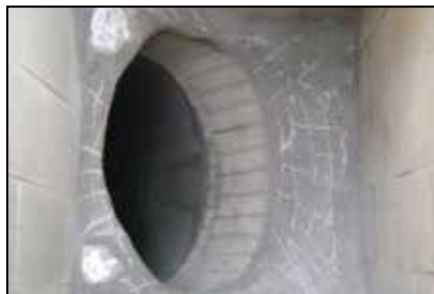
Los daños a las losetas cerámicas existentes causaron una parada no programada y pérdida de la producción
