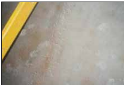
Corrosión y formación de picaduras en la compuerta del vertedero.
