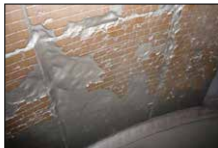
Paredes dañadas del pulverizador.
