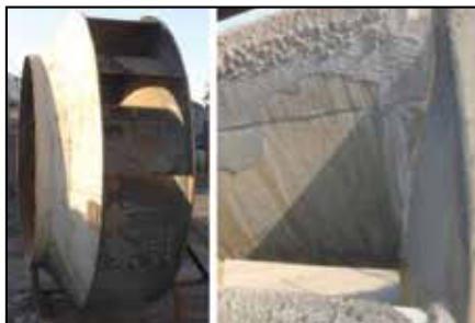
Acumulación de residuos en los álabes del ventilador.
