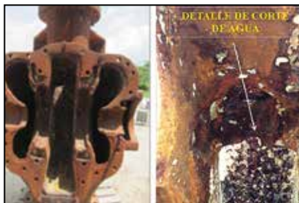
Cuerpo de la bomba según la inspección.
