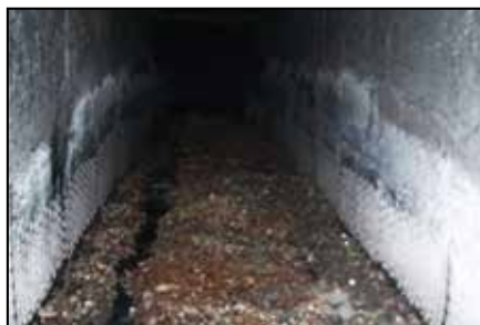
Canal de descarga con revestimientos de losetas/caucho dañados.
