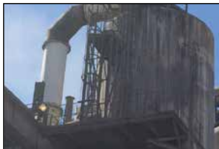
Refrigeración instantánea con extractor.
