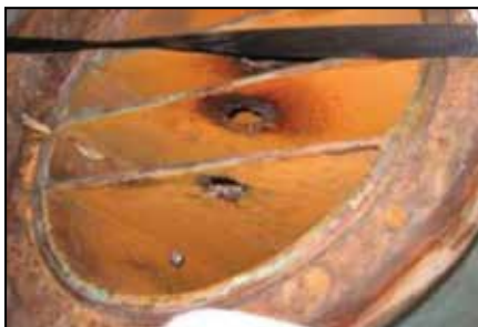
Platos divisores corroídos.
