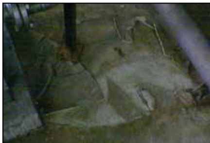
Manto de poliéster con fibra de vidrio desprendido.
