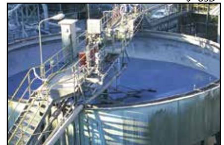
El ARC S2 aún está en excelentes condiciones.
